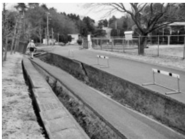
1メートル程陥没した通用門に向かう道路 提供：本人
