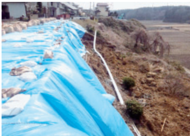
落ちたガードレール：崩落は住宅に迫り，ガードレールや側溝も崩れ落ちました＝南台住宅南側崩落斜面
