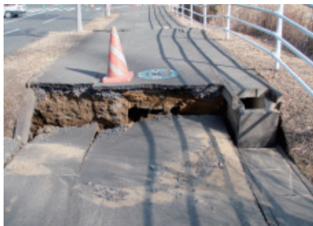
道路下でボックスカルバートがずれてしまったことによりできた歩道の段差＝五反田線
