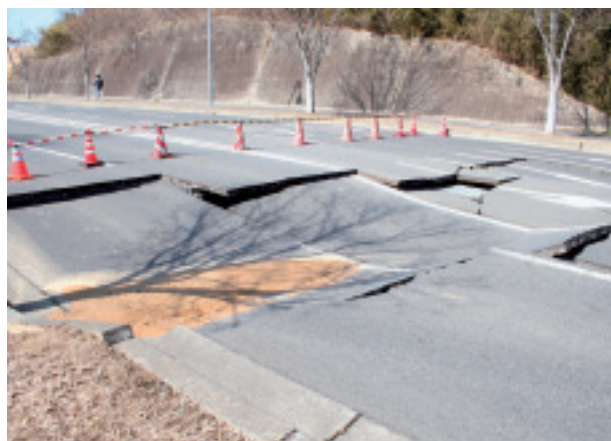
村道五反田線の「絆」入り口付近で路面が陥没した：液状化現象の跡も見られた
