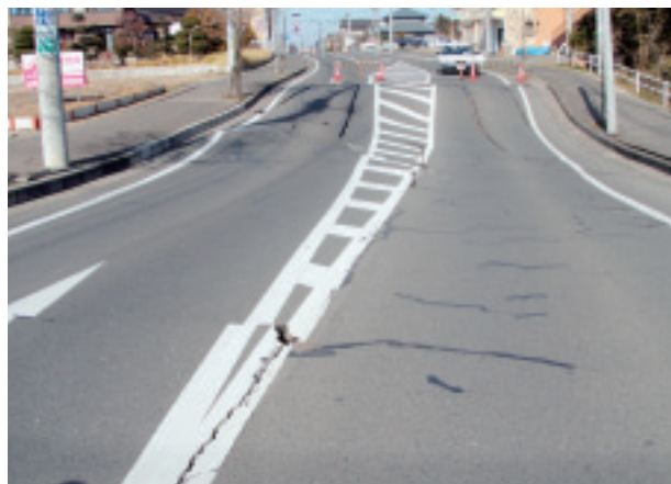
地滑りによる道路の陥没や亀裂＝小松原笠内線
