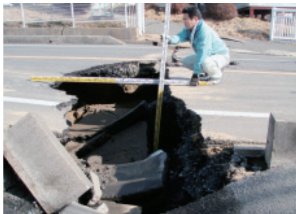
地滑りによる道路の破断陥没：それに伴うライフラインが被災＝村松／平原工業団地・動燃通り
