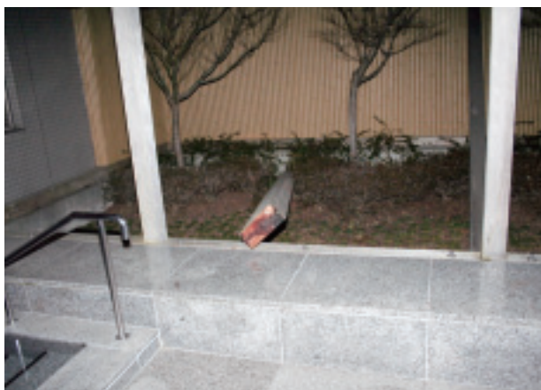
高齢者センター露天風呂の木製ひさしが落下
