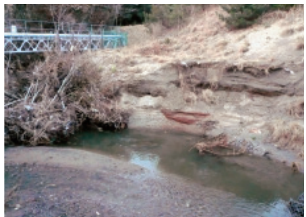
護岸が崩落した村松川河口＝新川合流付近
