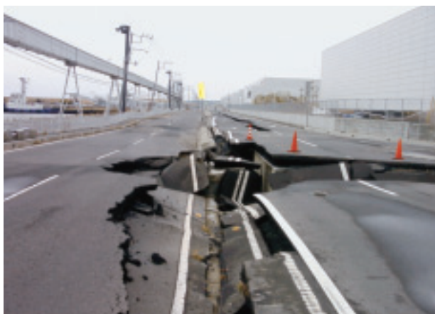
液状化による下水道管渠が被災し、道路が陥没＝常陸那珂港
