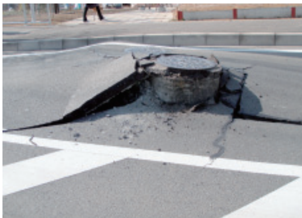
地滑りにより、波打ってしまった路面の間から、マンホールが浮上＝小松原笠内線
