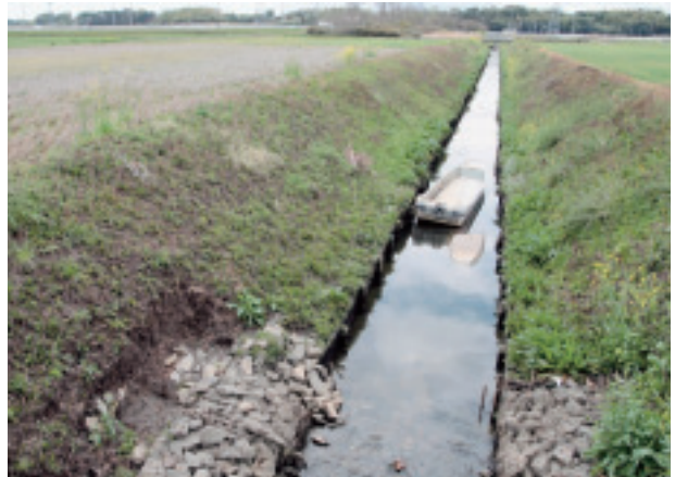
津波で運ばれた小舟と破壊された護岸＝竹瓦前川
