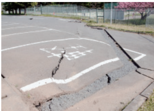
液状化で地盤の変形した駐車場＝村松砂山
