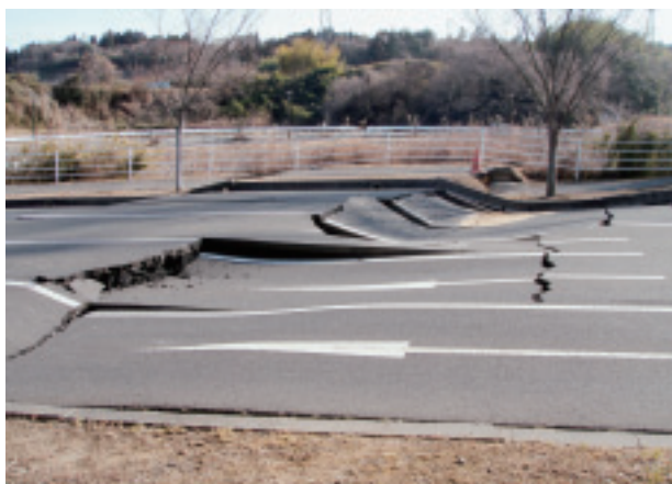
ボックスカルバートがずれ、採石が流れ落ち道路が破断陥没＝五反田線
