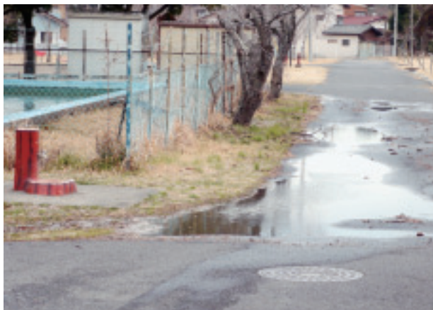
プールの水が溢水＝箕の輪団地
