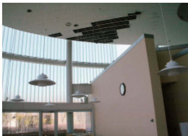
レストランの天井の一角がはがれ落ちる
