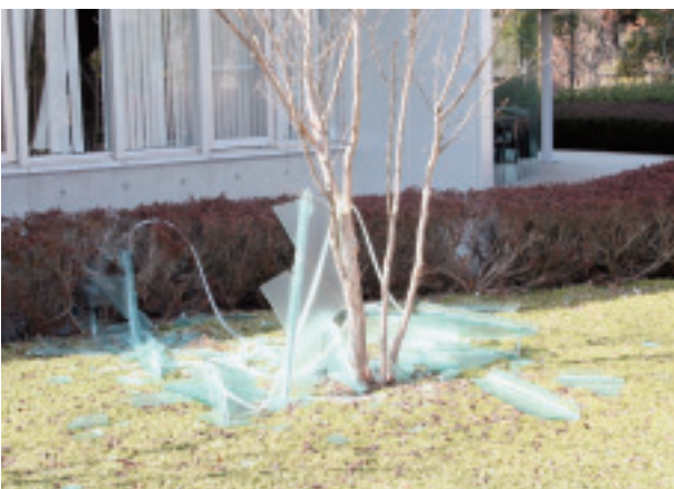
破損した採光ガラスの一部は、地面に落下し、一部はボランティア室の窓を突き破った
