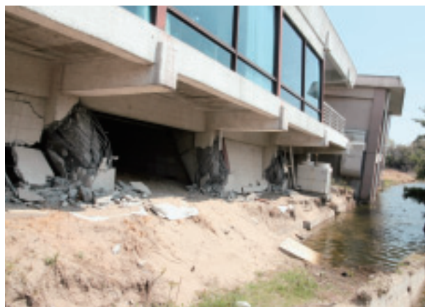
液状化で大破し阿漕ヶ浦に滑り込んだ建物＝村松砂山
