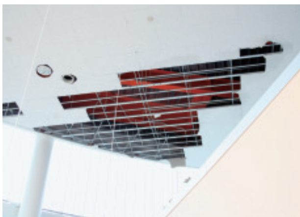
天井パネルの一部が落下
