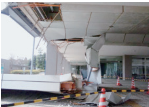
落ちた屋根：人がいなくて幸いでした＝役場庁舎正面
