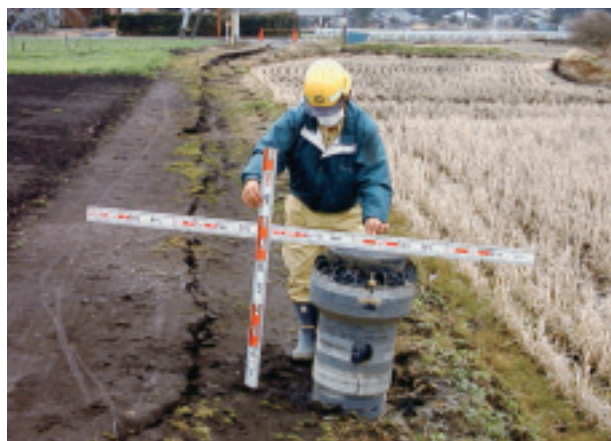
液状化によるマンホールの浮上＝船場
