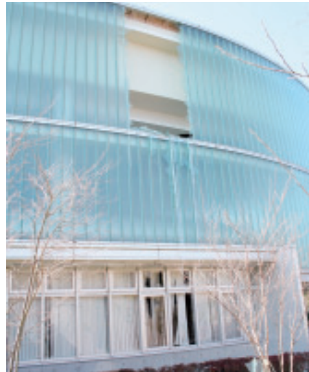
2 m× 5 m採光ガラスが破損
