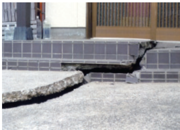
住宅の中央部を地割れが走り，床と壁が分断，更に地割れ線を境に片側が地盤沈下し，住宅が傾いた＝自宅 平成23年 3月11日
