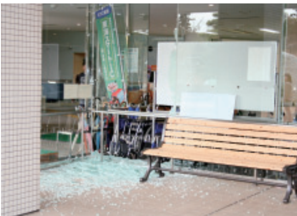
正面入り口付近のFIXガラスが破損
