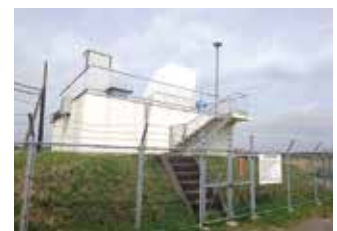
更新が必要な取水場
