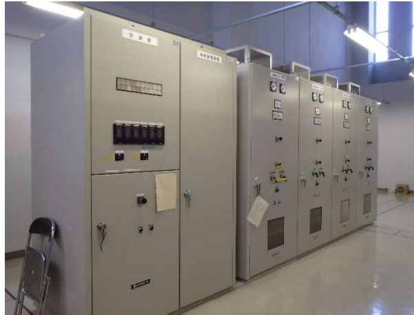
図 4.4 須和間配水場 電気盤
